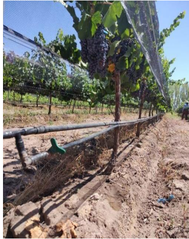
Figura 4.2. Derivación de tubería principal de sistema de riego por goteo.
